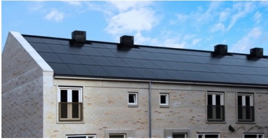
Dak-geïntegreerde zonnestroomsystemen (foto: AERspire/Heijmans)
